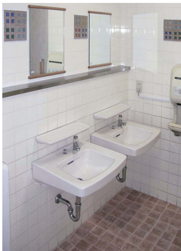
商業施設のトイレ
